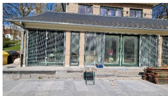
Photo des grilles installées. Photo CRMS. Mars 2026.
