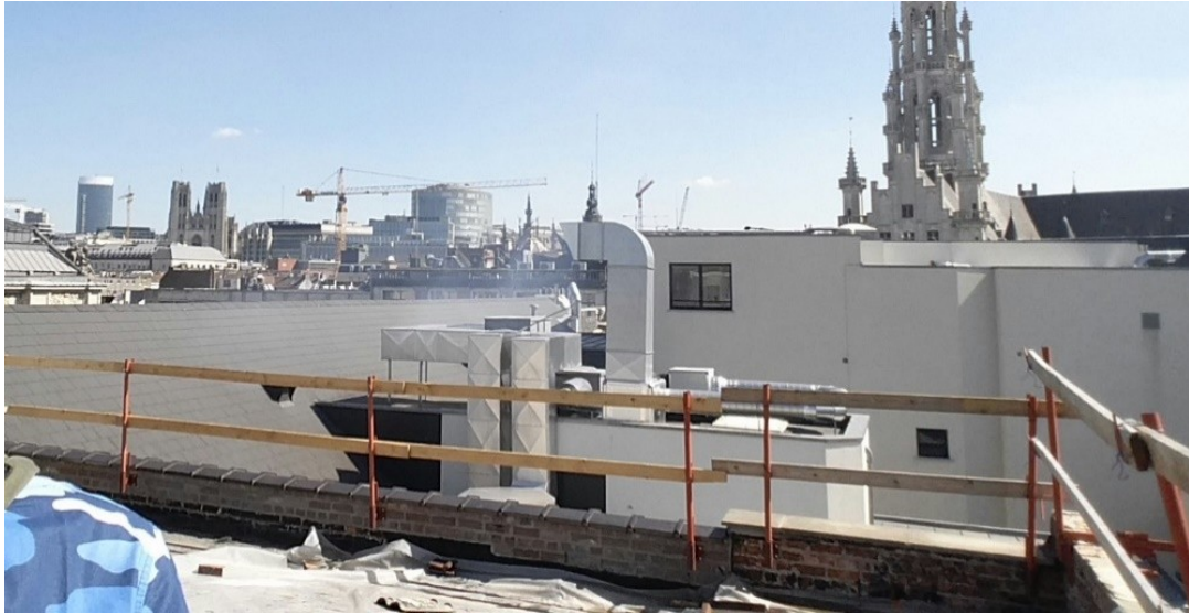
Technische installatie, foto gevoegd bij het dossier
