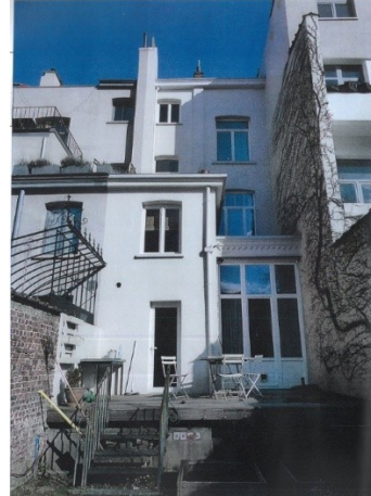
Vue de la façade arrière. Le nouveau volume présent sera mitoyen au n°27, à droite sur la photo. Les châssis du rez-de-chaussée et du 1 er seront remplacés par des châssis en alu, les autres restant inchangés. Photo tirée du dossier.
