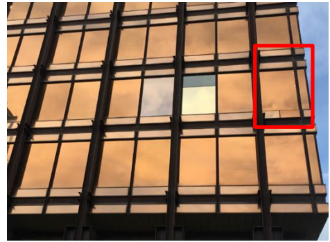
Mockup du nouveau vitrage. Le cadre rouge marque le vitrage qui sera utilisé (Infrastop WTB 40/24 / AGC COD AXA (*) – © urban.brussels
