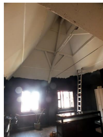
Vue sur les charpentes classées de l'annexe à l'arrière du n°11. Image tirée du dossier de demande
