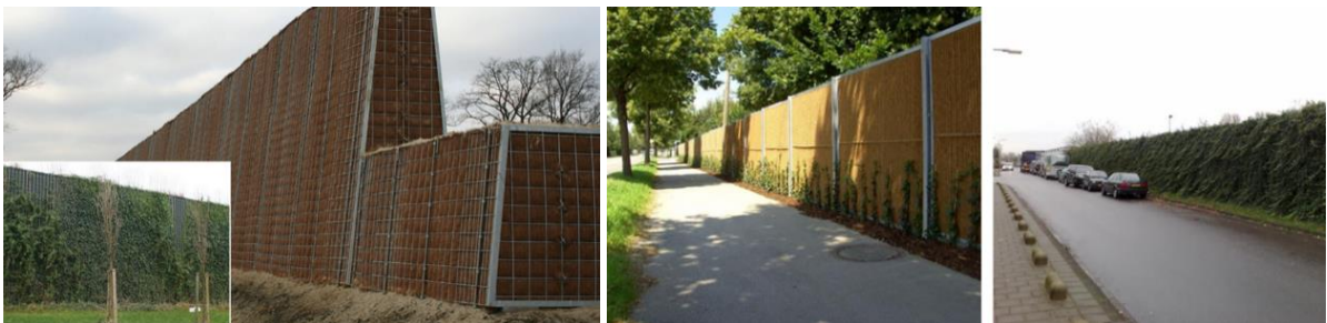
Photos de référence : l'écran massif et l'écran à paroi fine, avant et après végétalisation (extr. du dossier de demande)
