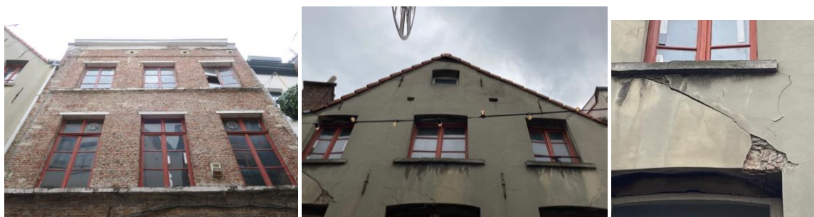
A gauche, le n°15 (façade néoclassique du 2 e ¼ XIX e siècle en briques entièrement décapées). Au centre et à droite, le n°19 (façade probablement du XVII e siècle présentant des fissures et des décollements). Photos CRMS, juin 2022
