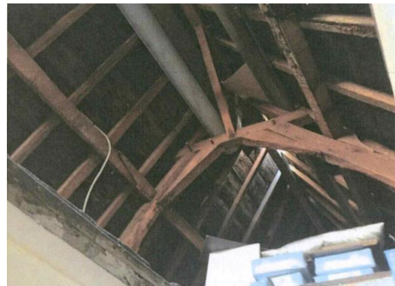
Vue de la charpente qui sera laissée apparente. Photo tirée du dossier de demande.
