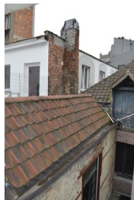
Articulation de l'aile de liaison avec la façade sur cour de la maison arrière
