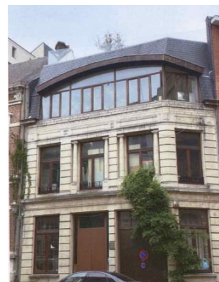
Vue de l'immeuble et du Garde-corps vitré installé. Image tirée du dossier.
