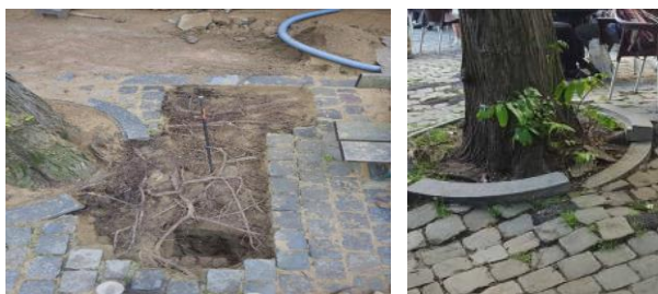
Développement des racines et état de dégradation des revêtements au centre de la place (photos tirées de l'exploration racinaire jointe au dossier)
