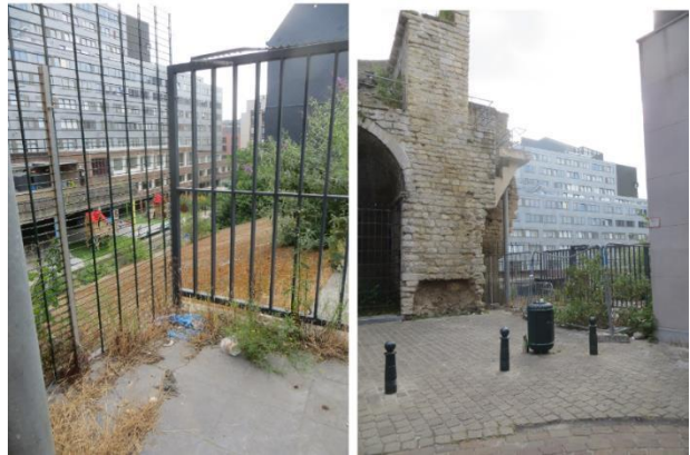
Situation actuelle de la portion des vestiges effondrés. Photo CRMS – juillet 2023
