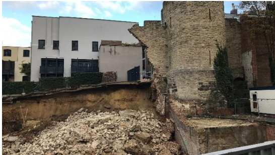
Photo de l'ancienne enceinte écroulée. Source : https://www.rtf.be/article/effondrement-d-un-pan-de-l-ancien-mur-d-enceinte-de-bruxelles-10076130
