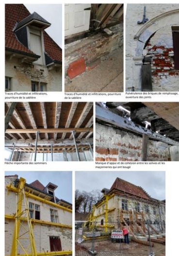
Situation existante et dégradations du bâtiment ; interventions pour la stabilité (2023 – Documents extraits du dossier de demande).
