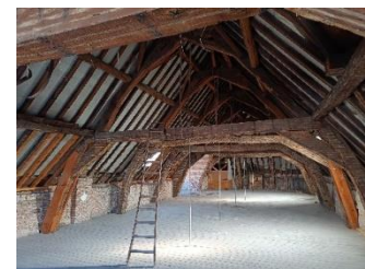
Charpente du corps nord, datant du XVII e s. (photo jointe à la demande)
