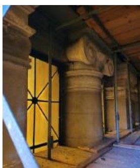
Gele beglazing van de ramen van de tamboer – foto uit het dossier
