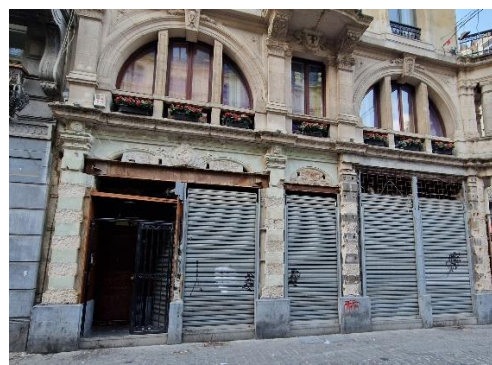
Façade rue Grétry. Situation existante : colonnes mises à jour. Photo CRMS avril 2026
