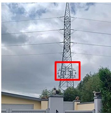
Vue du pylône avec les antennes GSM installées (en rouge).
