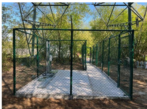
Vue de l'installation technique au sol, et du chemin d'accès Images extraites du dossier de demande
