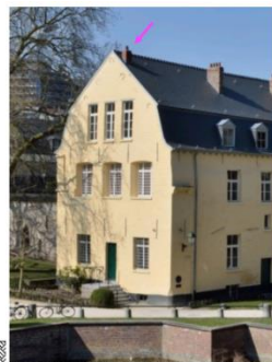
Présence d'une souche de cheminée au niveau du pignon sud
